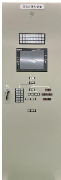
換気計測制御盤
