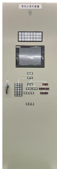
換気計測制御盤
