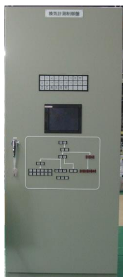
換気計測制御盤
