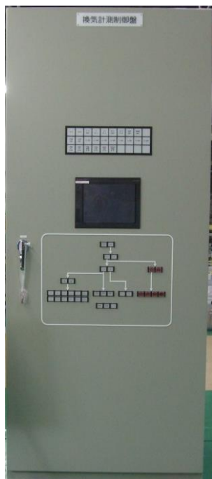
換気計測制御盤
